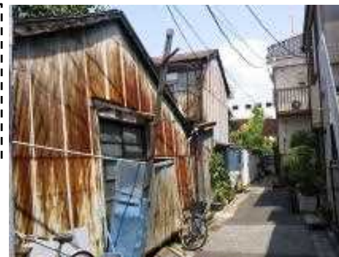
老朽木造住宅
