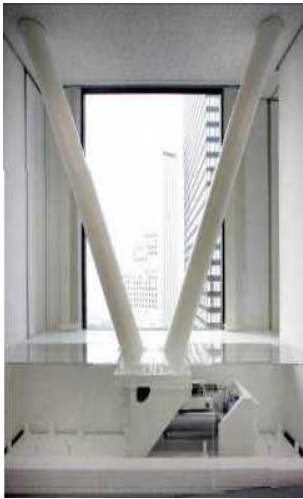
制振ブレース
