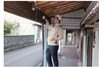
◀ 屋外警報機能も備えた機器の設置状況
