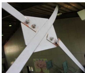
<鉛直ブレースの破断（熊本市）>
