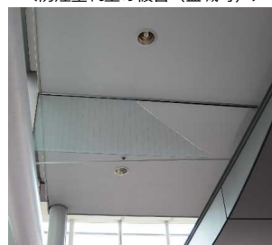
<防煙垂れ壁の被害（益城町）>
