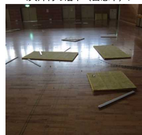
<天井材の落下（合志市）>
