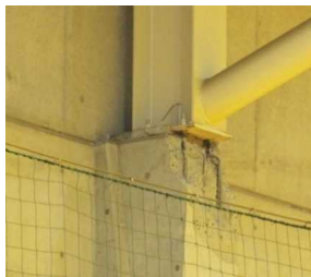
<屋根支承部の破壊（熊本市）>
